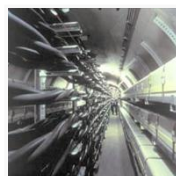
地中送電ケーブル
